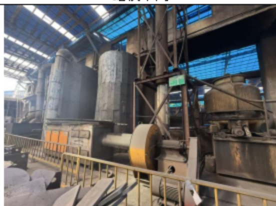
废气处理设施及 DA002 排气筒
