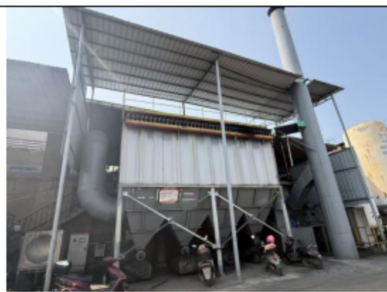
废气处理设施及 DA001 排气筒
