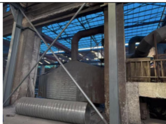
废气处理措施
