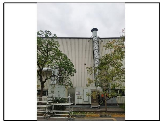
二级活性炭装置及排气筒
