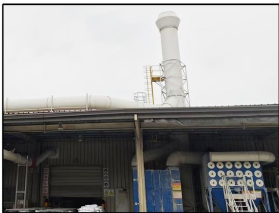
项目切割废气净化装置及排气筒
