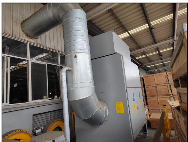
项目滤筒除尘器
