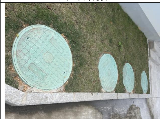
厂区内雨污水井
